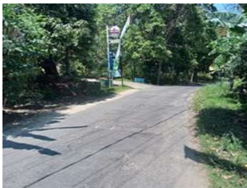
Gambar 1. Kerusakan Jalan di depan Bukit Love Karimunjawa
