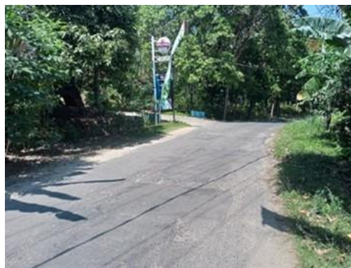
Gambar 1. Kerusakan Jalan di depan Bukit Love Karimunjawa.
